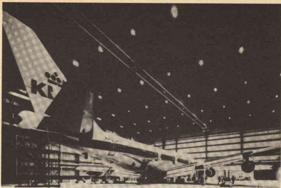
Il punto di illuminazione, in questo hangar di aeroporto, è situato all'altezza di 27,5 metri. Vengono usate 600 lampade al sodio ad alta pressione SON 400 W e l'illuminazione media è di 500 lux.
